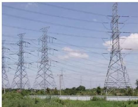
เสาไฟฟ้า
