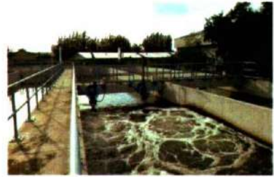
บ่อที่ใช้ในระบบบำบัดน้ำเสีย
